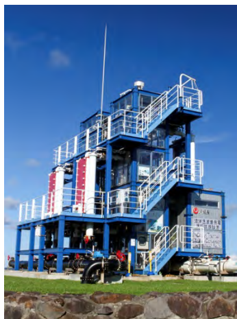
図2.2.25 沖縄県海洋温度差発電実証設備 (出典：沖縄県海洋温度差発電実証設備ウェブサイト)
