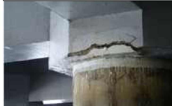
栈橋上部工梁部のひび割れ状況(R2岸壁)
