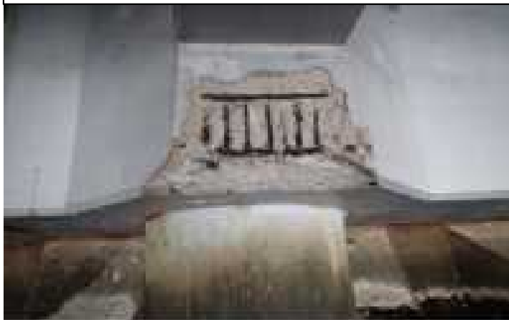
栈橋上部工梁部の鉄筋露出状況(R1岸壁)
