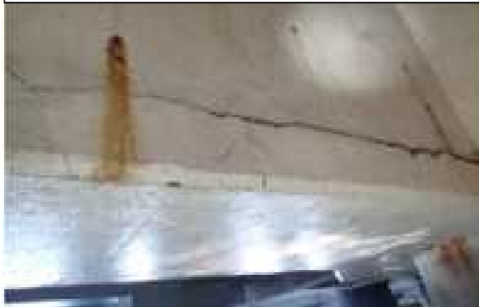
栈橋上部工梁部のひび割れ状況(R1岸壁)
