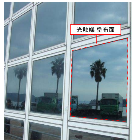
写真-3 港旅客ターミナルビル ガラス面の状況(8ヶ月後)
