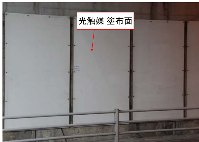
写真-4 トンネル坑口コンクリート 面の状況(8ヶ月後)
