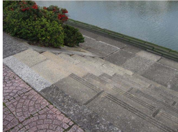
写真-6 護岸コンクリートブロックの状況 (8ヶ月後)
