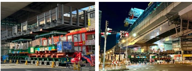
写真-5 移動作業車(下半部)の構築状況(左: 昼間に待機中の部材, 右: 夜間に組立)
