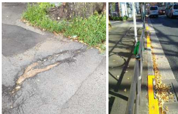
(写真-5 街路樹の根上)
