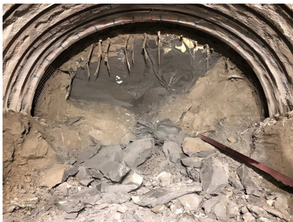
写真-2 岩塊の抜け落ち状況
