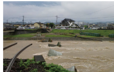
花月川橋りょう被災状況
