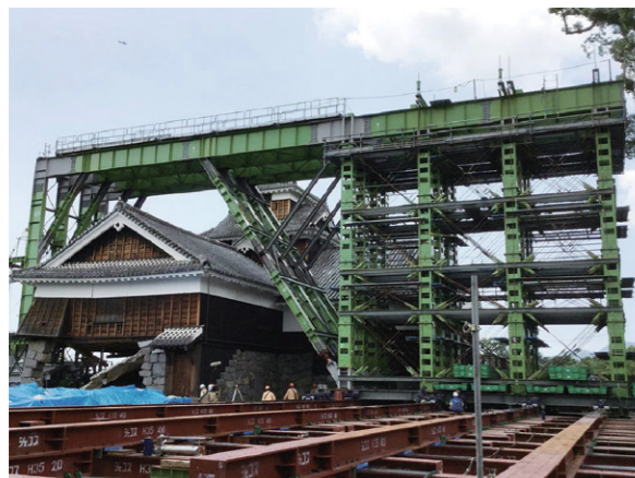
倒壊防止設備
