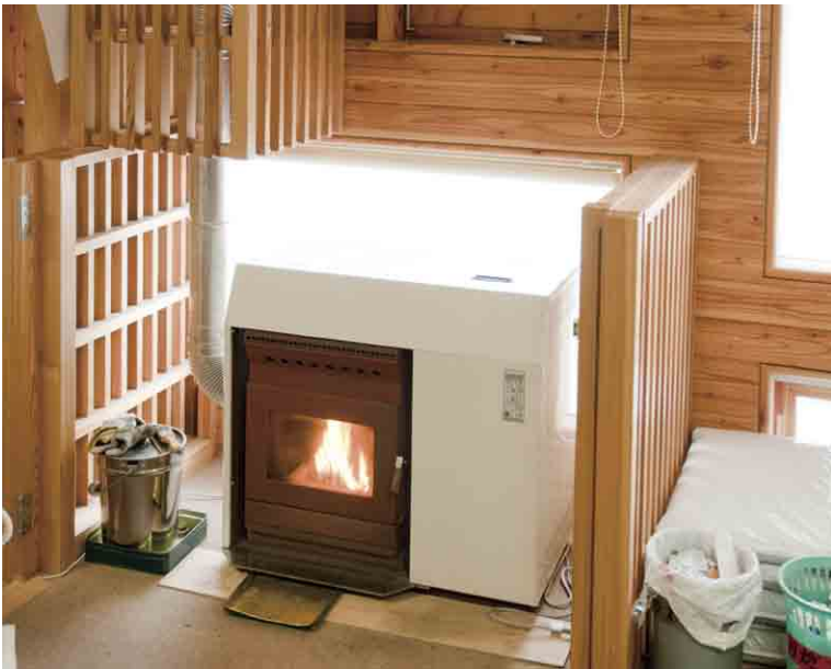
⑫ 自然エネルギー活用推進の一環として、木質ペレットを使用したペレットストーブを利用しており、柵で囲むことによって安全に配慮している。
