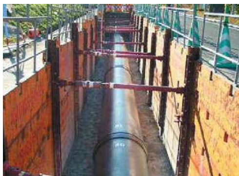
幹線水路(パイプライン)ダクタイル鋳鉄管(管の直径700mm)
