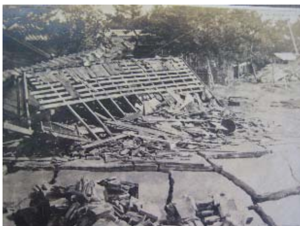
道路亀裂の状況（北条町 現在の館山市） 北条町は海底の砂地だったところが隆起し、そこに家々が立地しているため、基盤が弱く、多くの家屋が倒壊し、また、断層による亀裂が生じた。総戸数1,616軒のうち1,502軒が全壊した。死亡者も230人を数えた。
