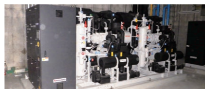
自然冷媒を使用した冷凍機 (キョクヨー秋津冷蔵(株)福岡事業所)
