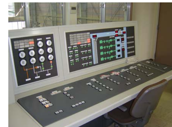
ゲート・ポンプの確実な操作
