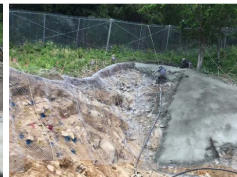
落石防護柵工
