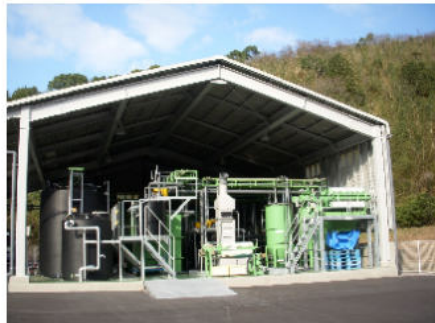
▲ 排水処理設備
