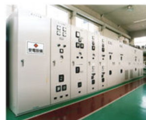
受配電盤・制御盤
