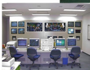
中央監視制御システム
