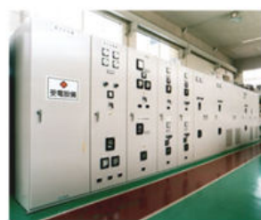
受配電盤・制御盤
