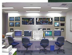
中央監視制御システム
