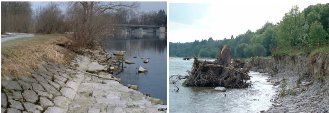
図 6.33 生態系に配慮されていない古い護岸(左)と被災した護岸状況(右)
