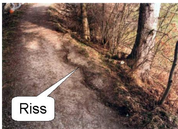
図 6.25 樹木による堤体への変状
