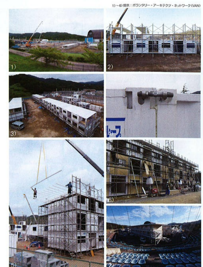
1) 野球場内にコンテナが運び込まれる。2)~3) コンテナを市松状に組み上げる。4) 接合金物によって連結されたコンテナ。5) 折半屋根の母屋組み取り付け。6) 外壁は各棟異なる色のサイディングボード貼り。7) 野球場観覧席より仮設住宅地を見る。
