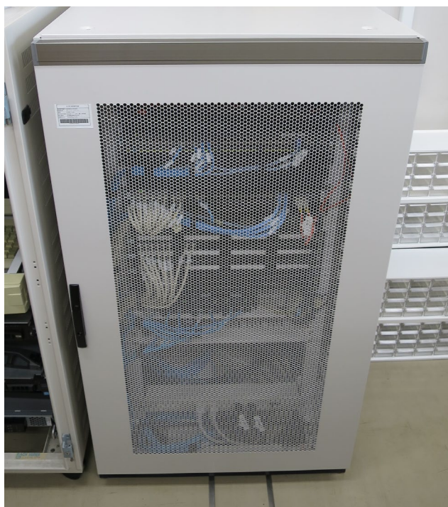
図1 第1学科棟ネットワークラック
