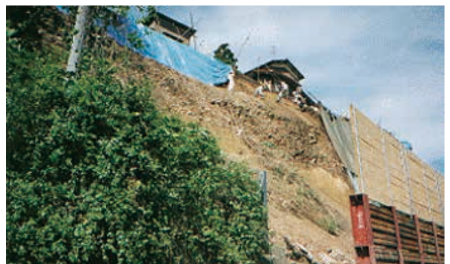
図-8 小立野 2 丁目付近のがけ崩れ現場
