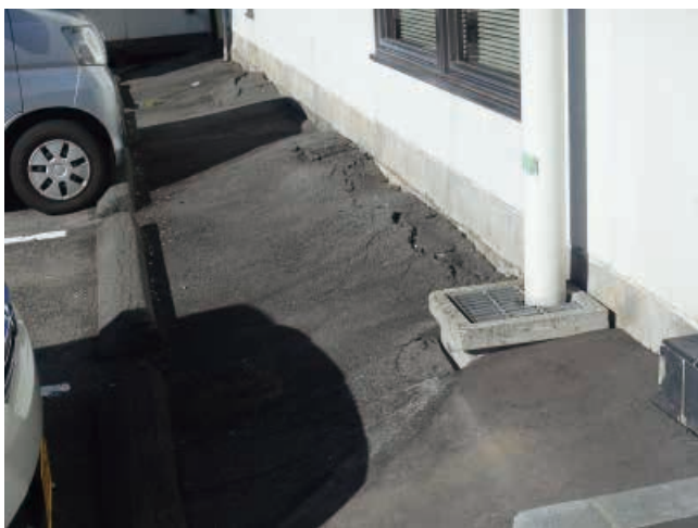
写真-5 抜け上がり現象
