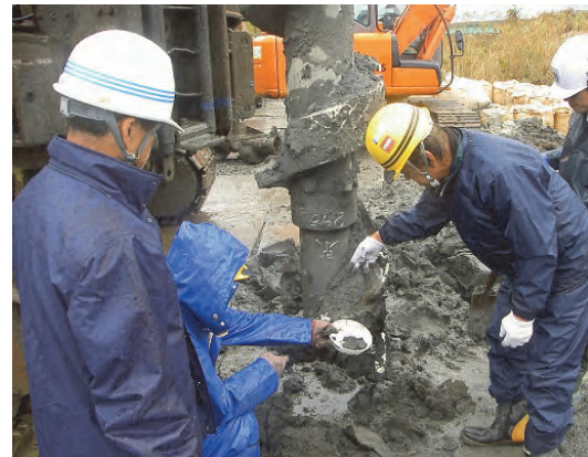
参考写真2：杭施工の立会確認をしている「JS 監督員」と「工事監理者」
