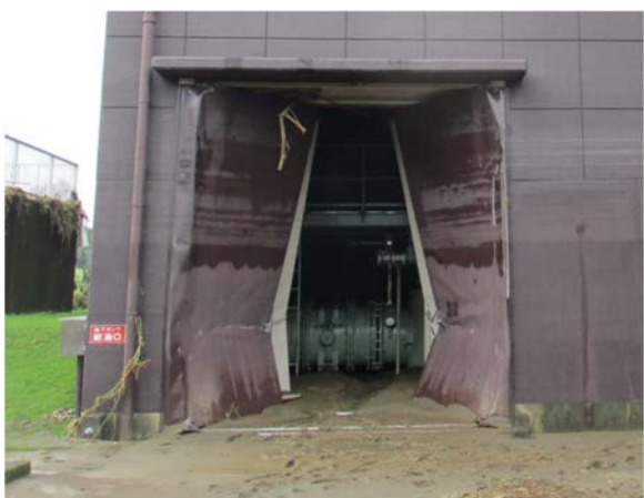
写真1：令和3年7月豪雨によるポンプ場の被災
