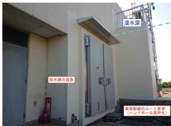
写真 5：放流ポンプ棟電気室の耐水化対策(防水扉設置、ハンドホールの高所化)
