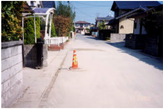
附-23 液状化による被害 (米子市富益団地) 水道管に被害が生じ、80世帯で断水
