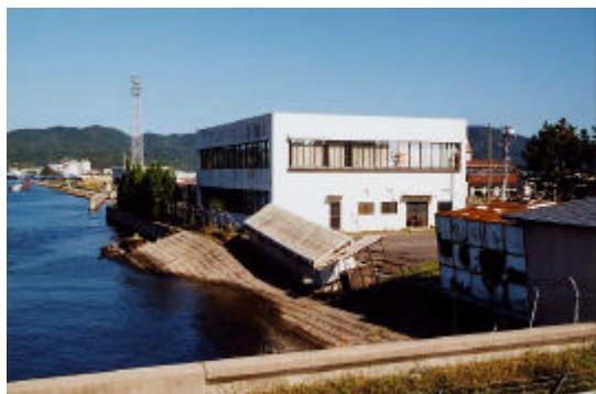
附-17 護岸近傍の建物の被害 (境港市中浦水門) 護岸の滑り破壊に伴い、自転車小屋が傾斜 <提供：清水建設(株)浅香氏>
