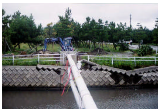
附-6 水道橋の被害 (境港市竹内工業団地) 附-5の左側を拡大
