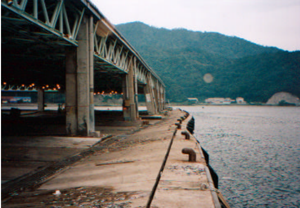
写真-11 漁港地区（通称かに棧橋）における被害
