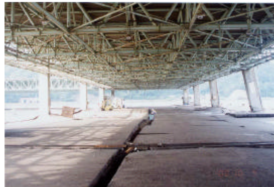
附-10 護岸の被害 (境港市昭和町) 護岸背後地盤の亀裂
