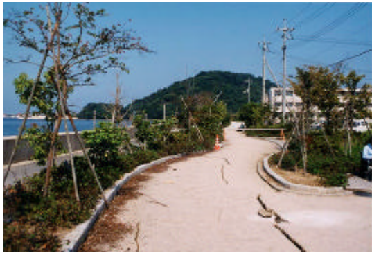
附-29 護岸の被害 (米子市錦海団地) 護岸背後地盤に生じた亀裂
