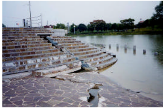
附-15 護岸の被害 (境港市サントピア橋) 液状化によって護岸が浸水 <提供：清水建設(株)福武氏>
