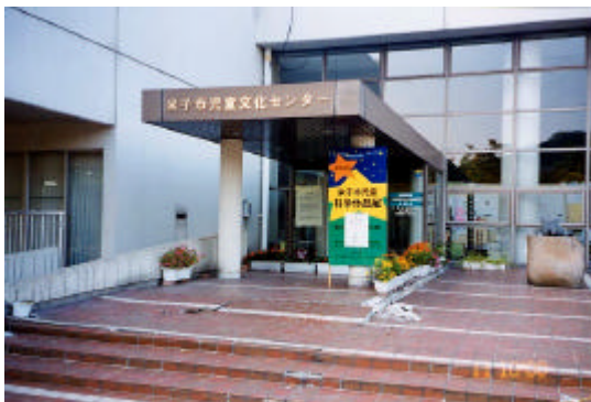
附-21 液状化による建物の被害 (米子市湊山公園) 液状化による周辺地盤の沈下
