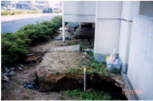
附-18 液状化による建物の被害 (米子市彦名団地) 周辺地盤沈下 30cm
