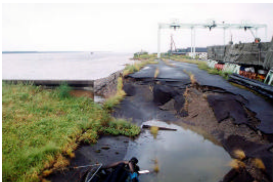
附-16 護岸の被害 (境港市中浦水門) 護岸背後に大きな陥没が生じている
