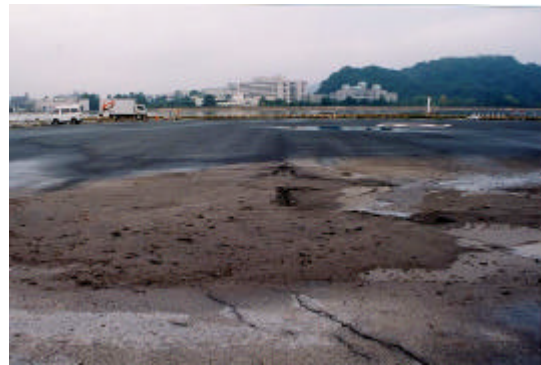
附-26 液状化による噴砂 (米子市米子港) 護岸背後地盤に生じた噴砂
