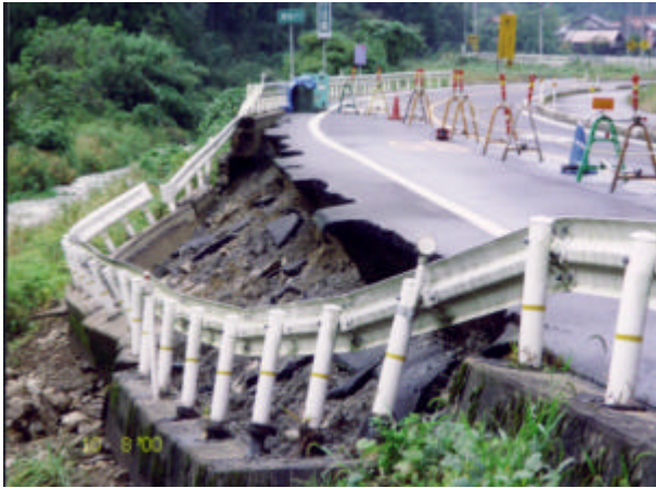
写真-4 日野町濁谷に川側斜面崩壊によるガードレールの落下
