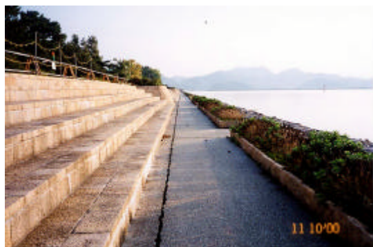
附-28 護岸の被害 (米子市湊山公園) 護岸背後に生じた亀裂
