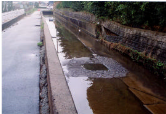
附-20 液状化による被害 (米子市彦名団地) 河床に生じた噴砂
