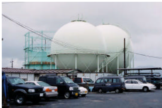
附-27 球形ガスホルダー (米子市米子港) 敷地内は噴砂有り、ガスホルダーに構造被害なし
