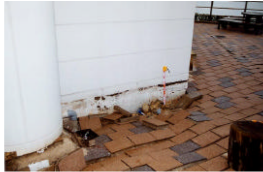
附-4 液状化による沈下 (境港市竹内工業団地) 周辺地盤の沈下 30cm
