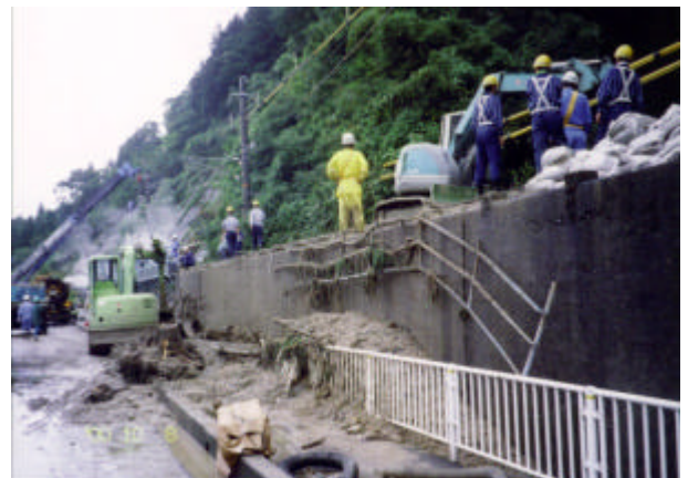
写真-3 日野町貝原の JR 伯備線及び国道 181 号線への斜面崩壊
