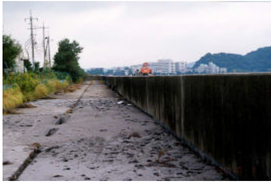
附-25 護岸の被害 (米子市米子港) 護岸背後地盤に生じた噴砂と亀裂
