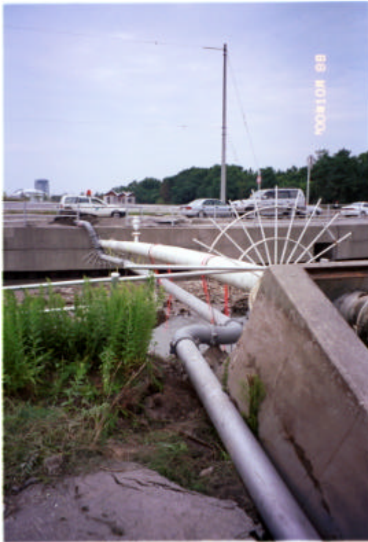
写真-8 竹内工業団地の西部の承水路に架かる水管橋の被害状況
