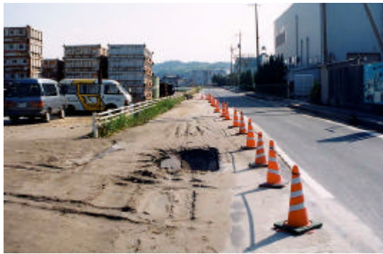
附-31 護岸の被害 (安来市安来港) 道路の陥没
