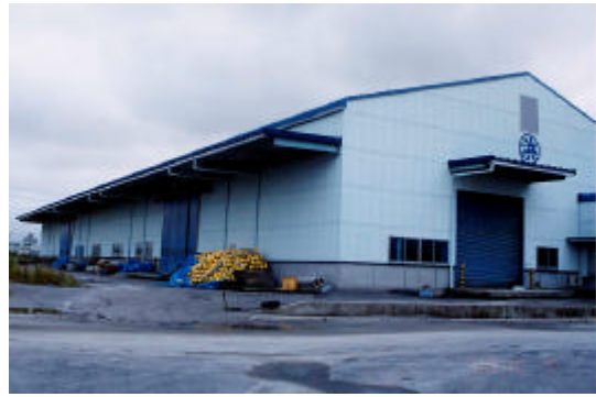
附-2 竹内工業団地内の倉庫 (境港市竹内団地) 建物周囲に噴砂有り、周辺地盤の沈下
