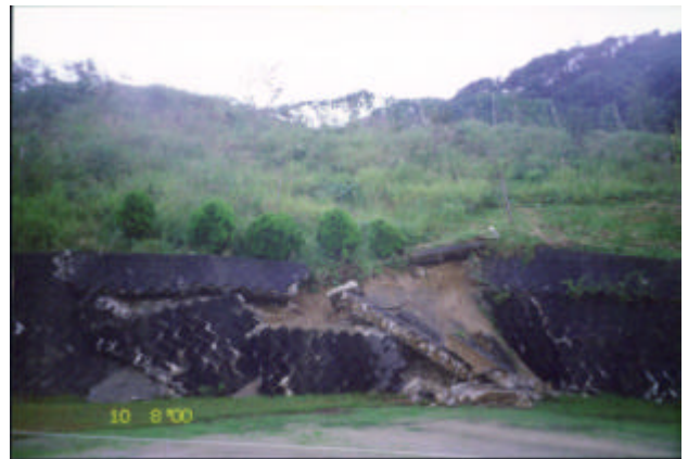
写真-6 法勝寺中学校軟式野球場の斜面下部擁壁の崩壊
