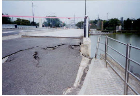
附-14 取付け道路の被害 (境港市サントピア橋) 液状化によって取付け道路が沈下 <提供：清水建設(株)福武氏>
