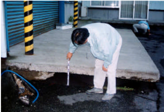
附-3 液状化による沈下 (境港市竹内工業団地) 周辺地盤の沈下 25cm
