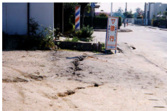
附-22 液状化による被害 (米子市富益団地) 住宅横に生じた亀裂と噴砂
