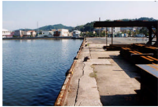
附-30 護岸の被害 (安来市安来港) 護岸背後の亀裂
