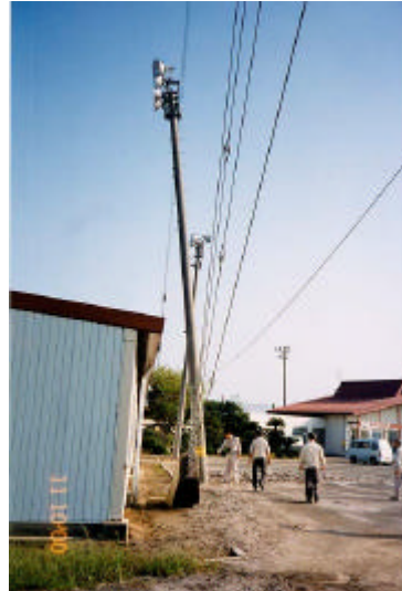
附-19 液状化による被害 (米子市彦名団地) 電灯の傾斜
