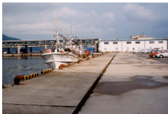
附-12 護岸の被害 (境港市昭和町) エプロンの沈下 20cm
