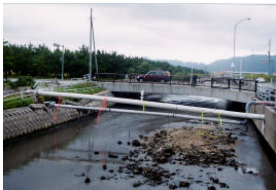
附-5 水道橋の被害 (境港市竹内工業団地) 埋立て地盤側(写真右)が沈下し、パイプ変形
