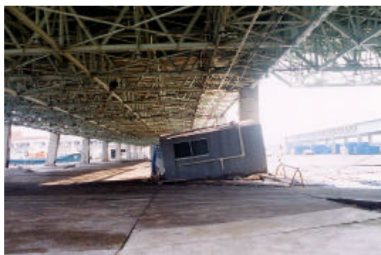
附-11 護岸付近の建物の被害 (境港市昭和町) 液状化により建物が傾斜
