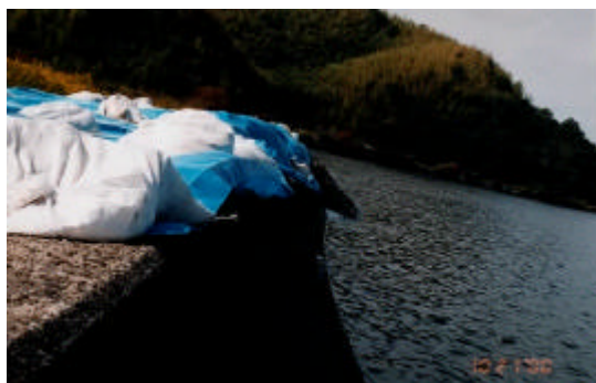
附-33 安来市鉄工センター護岸の破壊
