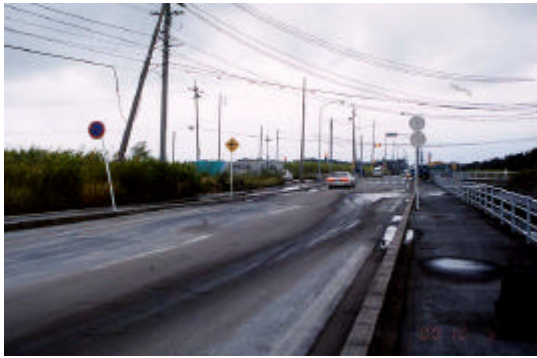
附-7 液状化による道路の被害 (境港市竹内工業団地) 道路がうねっている
