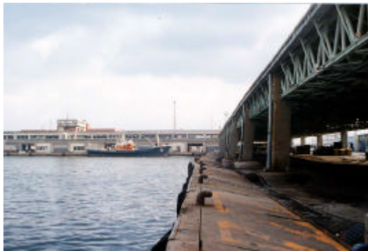
附-9 護岸の被害 (境港市昭和町) 護岸が約 1.5m 移動、荷揚場の柱の傾斜
