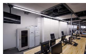
直流給電オフィス
