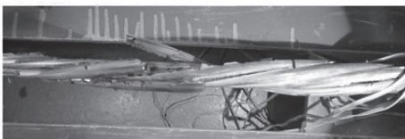
写真 - 5 破断状況 (21.8 mm 被覆 PC 鋼より線)
