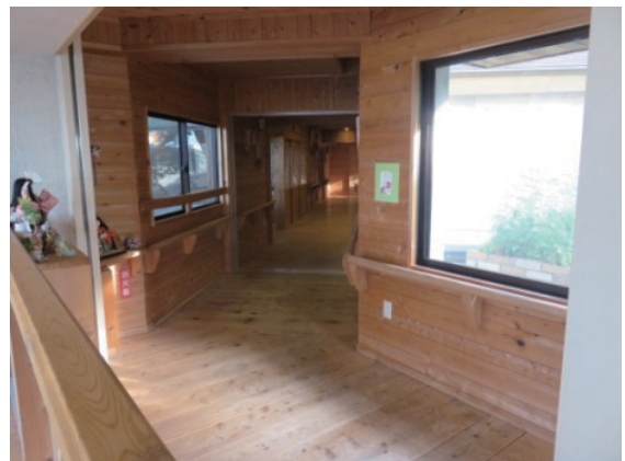
写真8：曲がった木造の廊下
