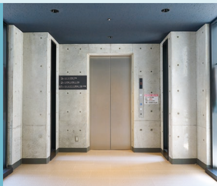
エレベーター* 改修工事によりエレベーターを新設しました。
