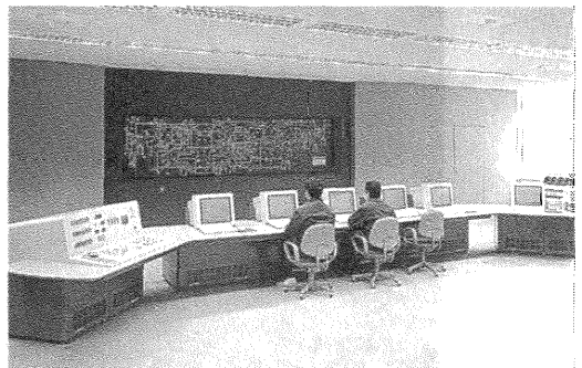
写真5 水管理センター
