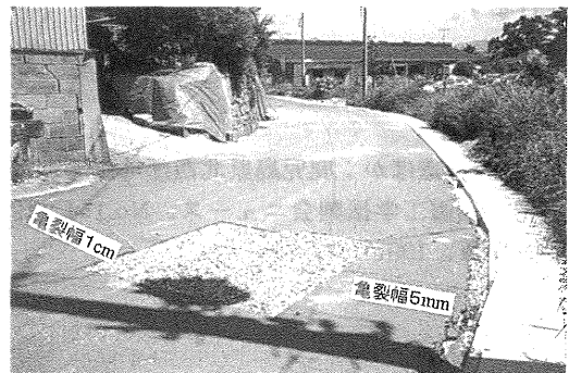
写真5 傾斜地盤の亀裂例（鹿児島県第二北西部地震）（図5—No.⑧地点）
