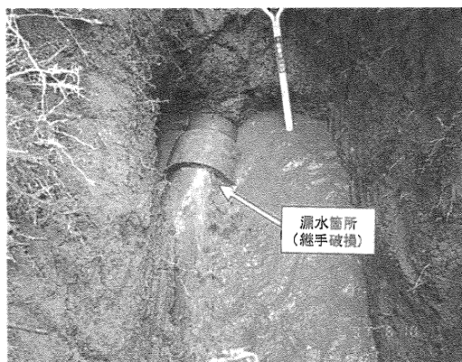
写真3 管路の被害状況例 (3) (鹿児島県第二北西部地震) (ACP φ200 継手破損、宮之城町内)
