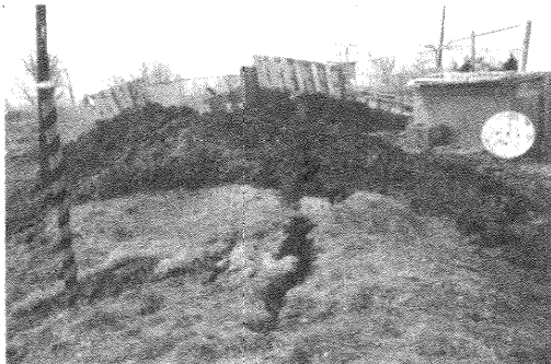
写真一 3 盛土地帯の地割れ状況 (緑ヶ丘団地内)
