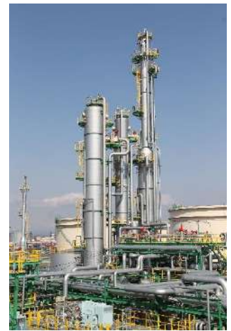
分離・回収設備
