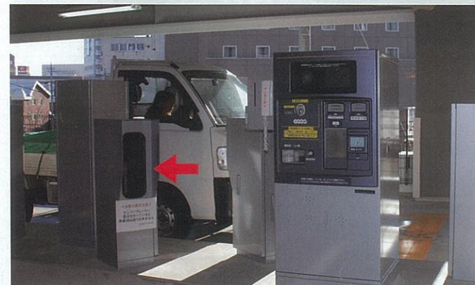
▲事前精算システム④出庫のさい1階で精算すると、⑥出口ゲートで車番カメラ(矢印)が車両ナンバーを読み取り、精算済みであることを確認してゲートが上がり、利用者はそのまま外へ出られる。
