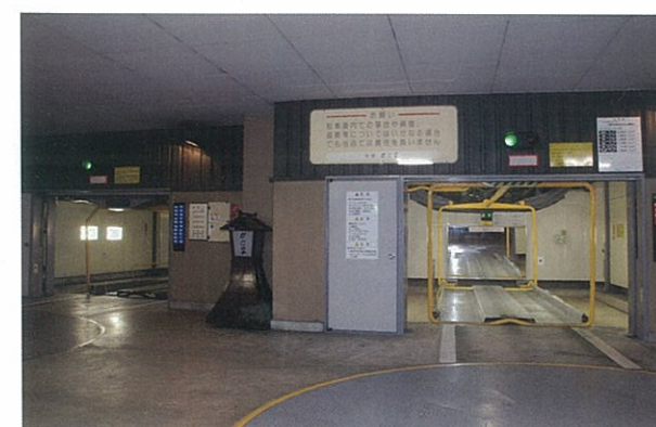
▲同店の駐車場。改造後（右）と従来（左）の立駐入口
