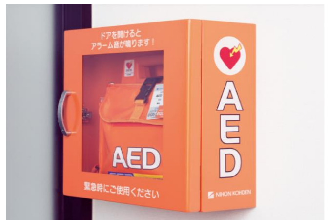
庁舎内に設置されたAED
