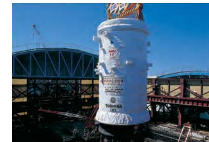
原子炉圧力容器
