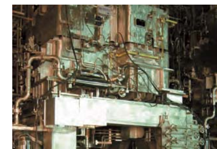
高レベル廃液ガラス固化設備
