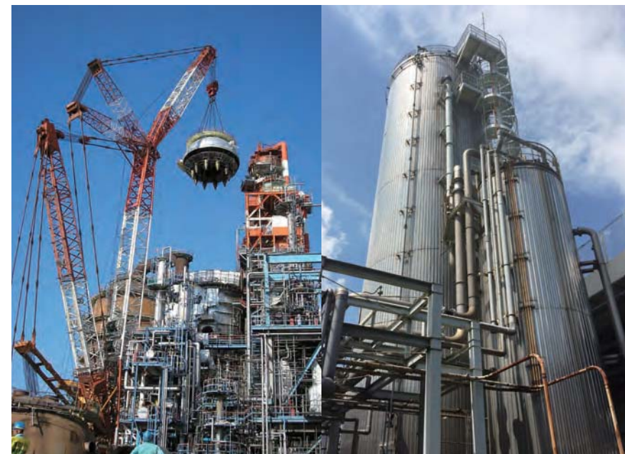
圧力容器 / 排水処理設備
