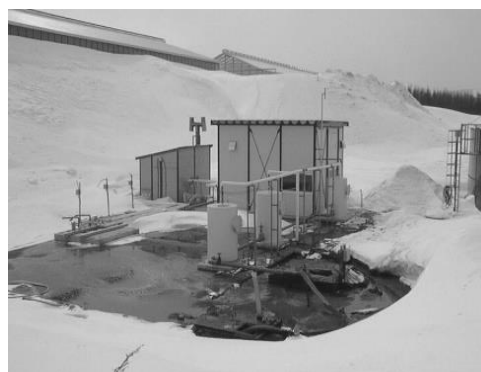
メタン発酵処理施設
