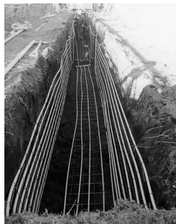
樹脂製柵状採熱管
