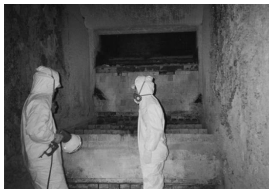
ごみ焼却炉損傷調査の様子
