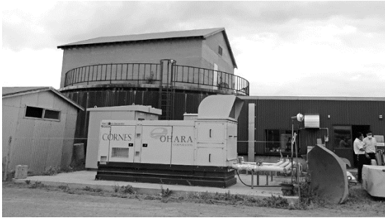
バイオガス発電プラント（興部町）
