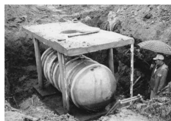
FRP 製地下埋設灯油タンク
