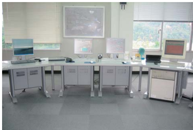
5 西宮市水道局丸山浄水場の中央監視装置
