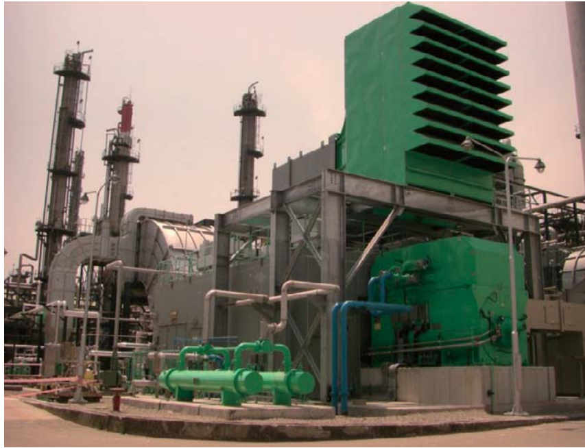
1 韓国・大韓油化工業株式会社 H-25 ガスタービン発電設備
