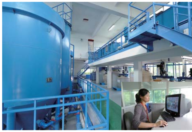
工場内の用水循環設備
