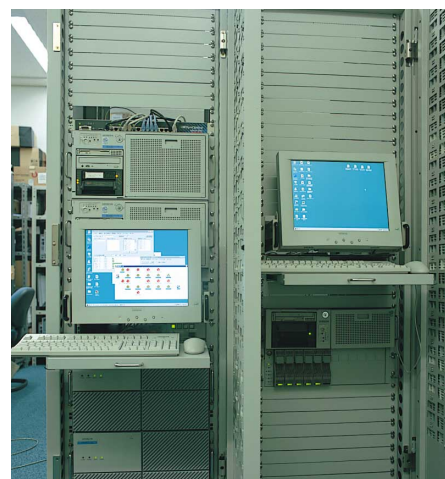
CosmiccubeサーバとDATAFRONTサーバとして稼働しているHA8000シリーズ
