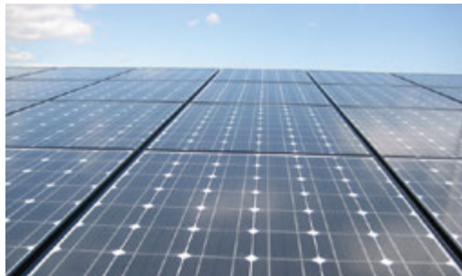
太陽光発電システム
