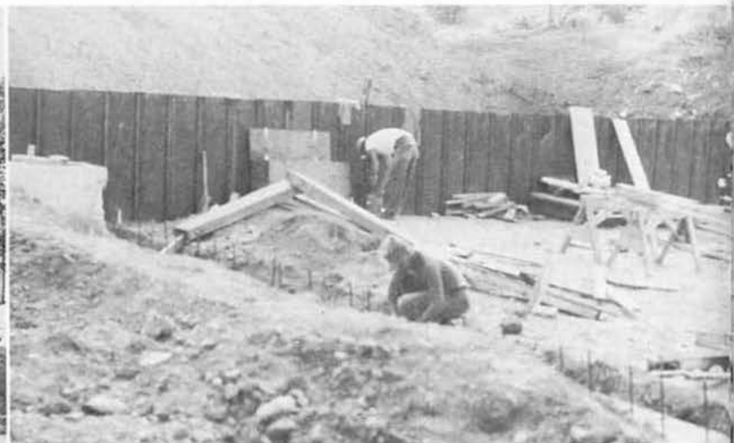
Lime Floc Tank
