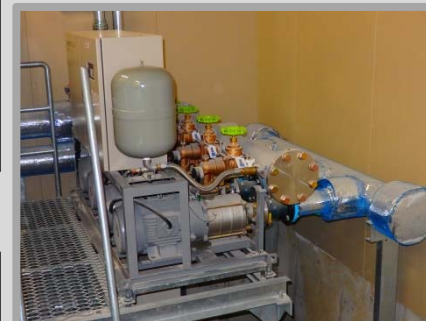
上水加圧給水ポンプ
