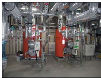
機械室・温室ヒーター
