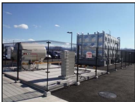
外部受水槽・LPG装置
