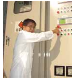
常用発電機稼動開始
