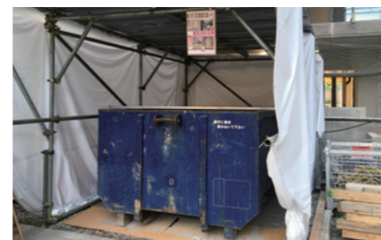
廃石膏ボード分別ヤード(屋根とシートによる防雨対策)
