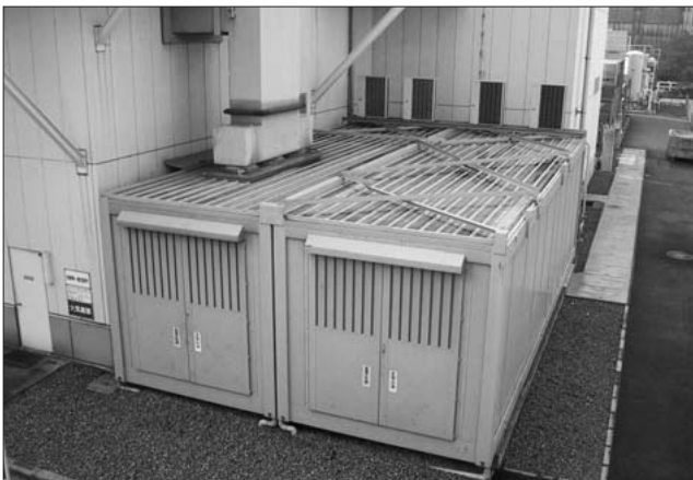
図8 電気制御装置収納コンテナ
