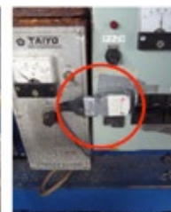
写真2 DC電源にプラグ接続状況 (主電源のON/OFFと自動的に連動)
