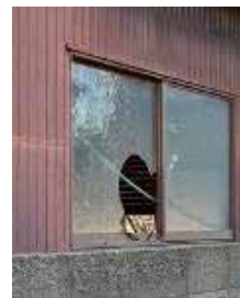
窓が割れた 管理不全空家
