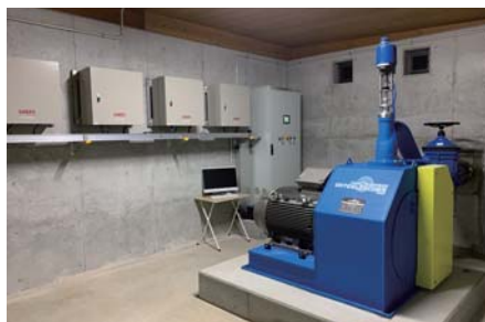
黒土川小水力発電所のオーストリア製水車発電機
