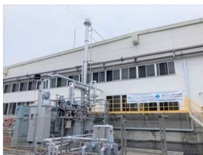
水素ボイラー
