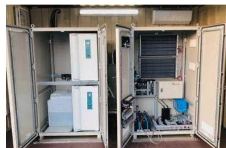
純水素発電システム(10kW)の扉開放
