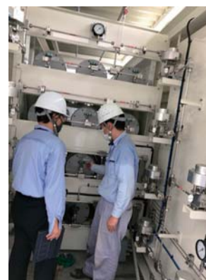
蓄圧器の設置施設 実例の内部(愛知県豊田市)
