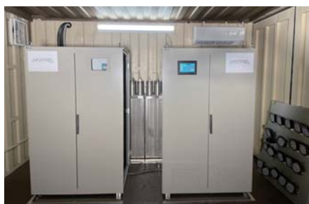
純水素発電システム(10kW)の全体
