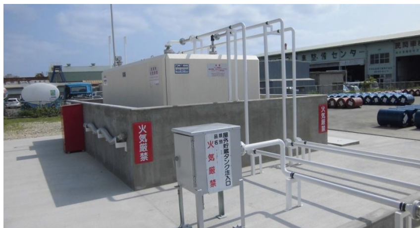
図2-43 エッカ石油(株)西原営業所のコンボルトタンク
