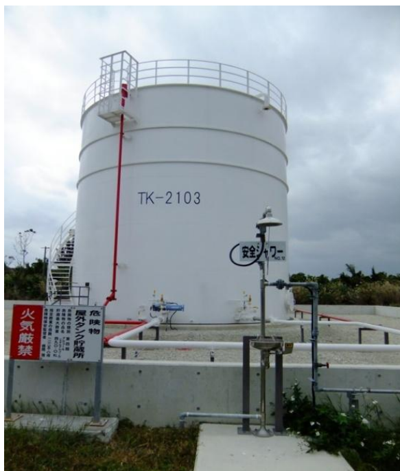
図 2-30 490kL バイオエタノール貯蔵タンク （南西石油株）
