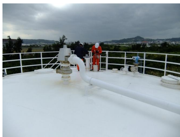
図 2-31 大気開放弁への吸込み口の配管接続
