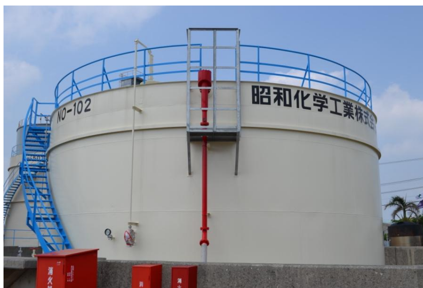
図 2-32 昭和化学工業(株)赤崎ターミナルの 490kL タンク
