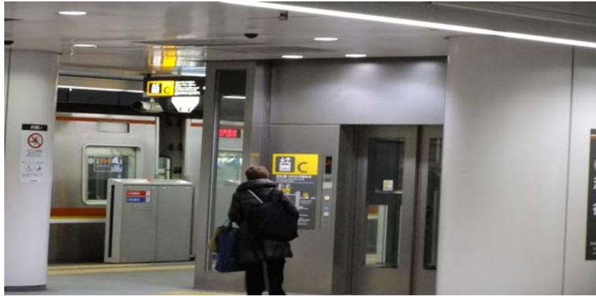
写真 2.1.2-8 地下鉄副都心渋谷駅ホーム改札用昇降エレベータ
