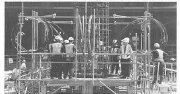
図2 地中熱交換用チューブの基礎杭への取り付け 地中熱利用杭施工状況
