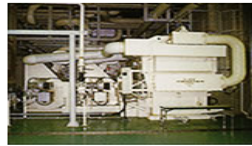
ガス吸収式冷温水機
