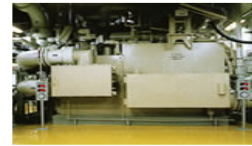
海水熱源ヒートポンプ
