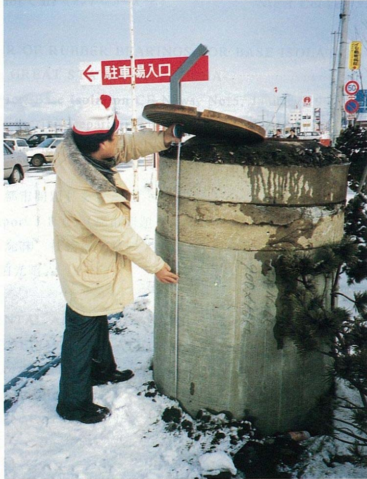
口絵写真-4 桂木地区の下水道マンホールの浮上
