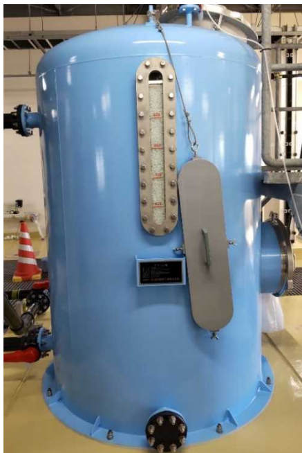
離島海水淡水化施設の ミネラル添加槽 (外観)
