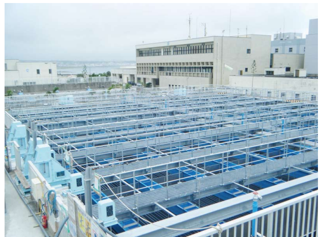
沈でん池改良後(傾斜管)
