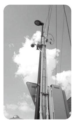
防犯カメラの設置状況
