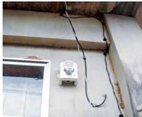
屋外の警報装置(ホーンストロボ)設置状況
